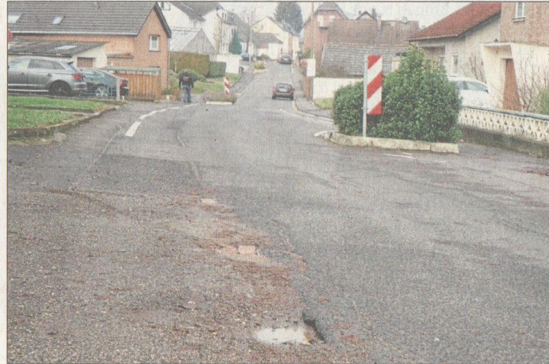
Risse und Schlaglöcher: Die Mertener Offenbachstraße ist sanierungsbedürftig.
