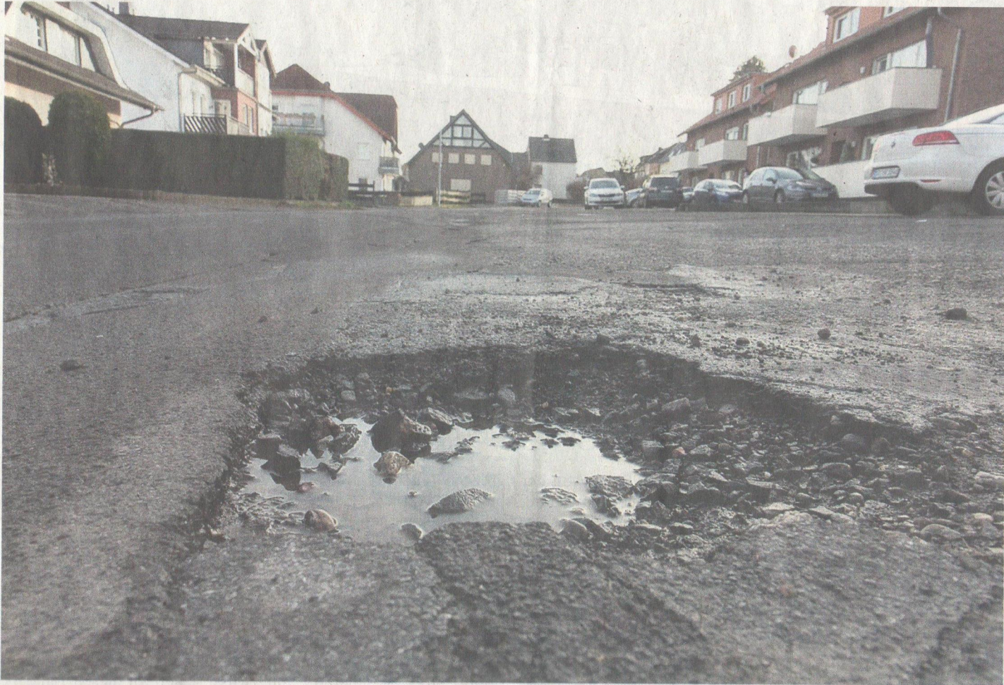
Tiefe Schlaglöcher, keine Bürgersteige – so marode ist der Zustand der Offenbachstraße.
